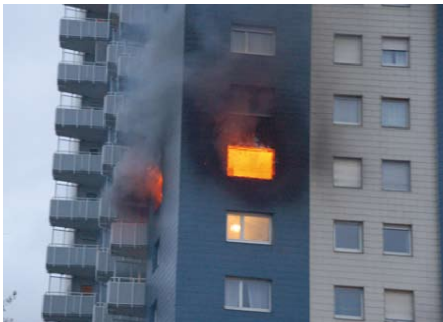
Stuttgart: Durch Windeinfluss wurde im März 2008 ein Feuer im sechsten Obergeschoss massiv angefacht.
