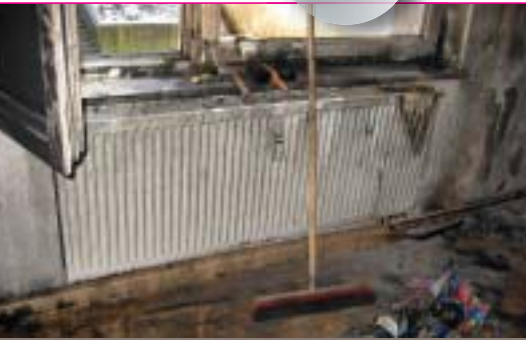
Bild 3 | Die deutlichen Brandspuren im Kinderzimmer lassen das Brandausmaß erkennen
